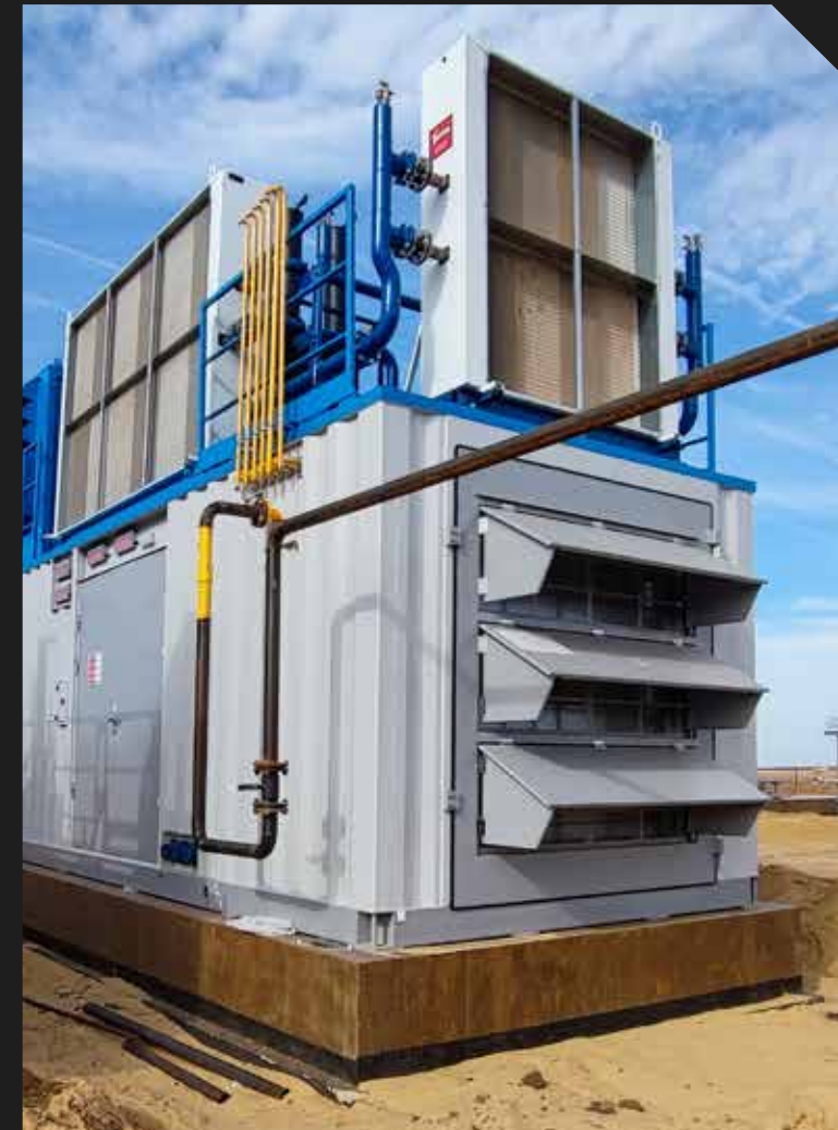
Два энергокомплекса 2,1 МВт и 1,4 МВт для КСПГ Газпром
