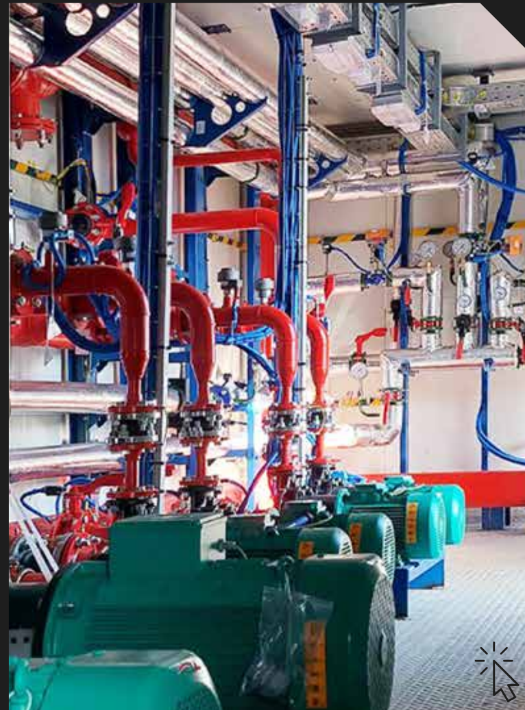
Блочная насосная станция для вахтового посёлка
