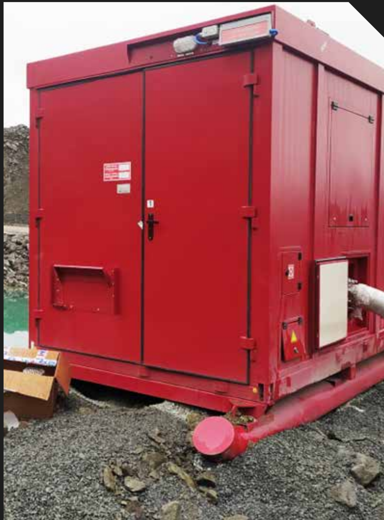
Дизельная насосная установка для перекачивания кислотных сред
