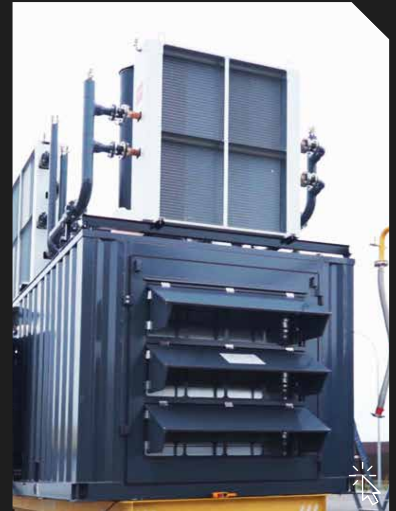
Электростанция 1 МВт для стекольного завода
