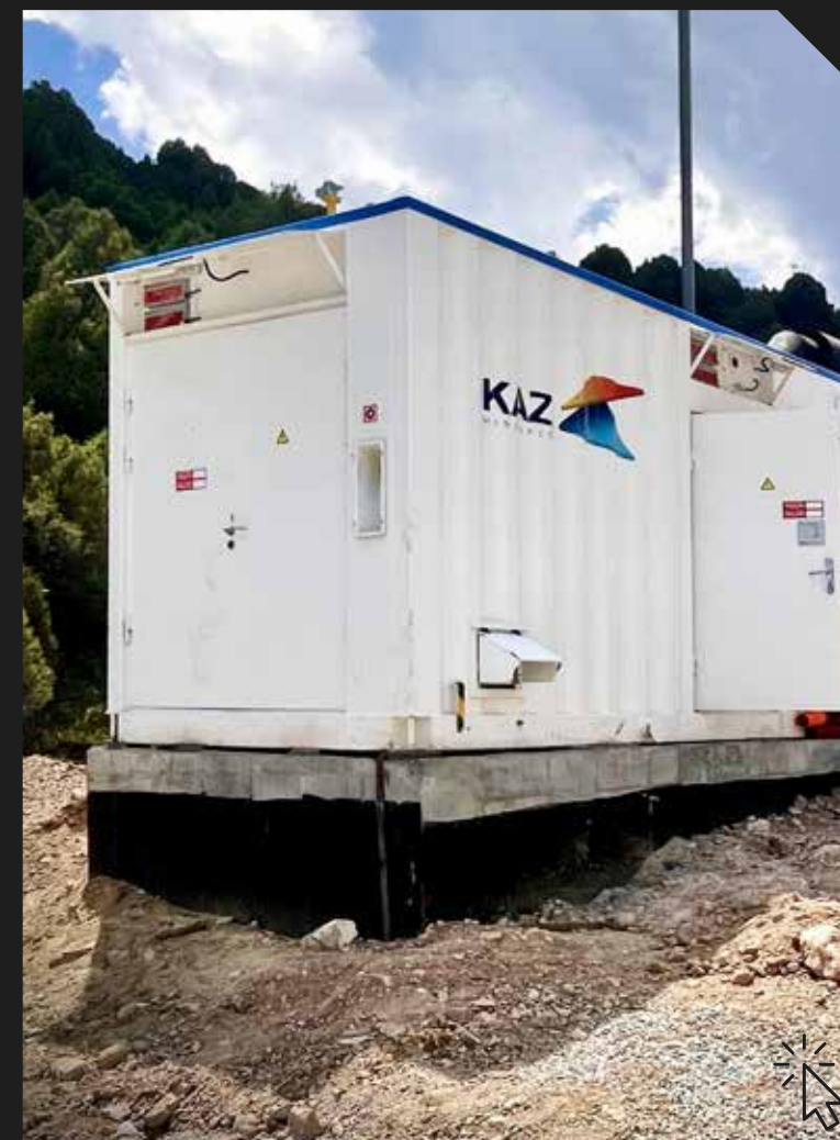
Энергокомплекс 4,5 МВт для подземного рудника в Киргизии
